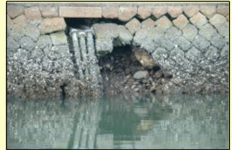
図 4.3 老朽化の状況
