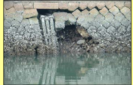
図 2.24 老朽化の状況
