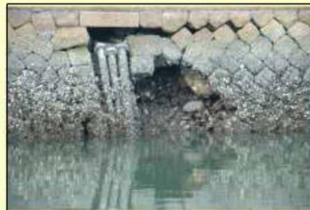
図 2.24 老朽化の状況
