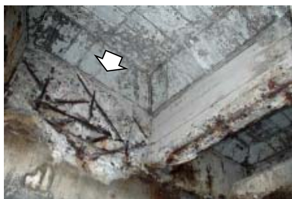
エプロン下部（コンクリートが剥離）
