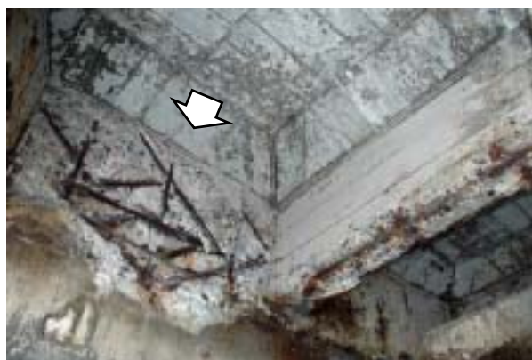
エプロン下部（コンクリートが剥離）
