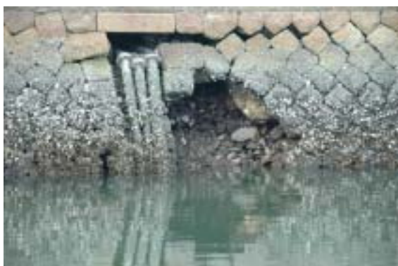
崩落した石積構造の物揚場
