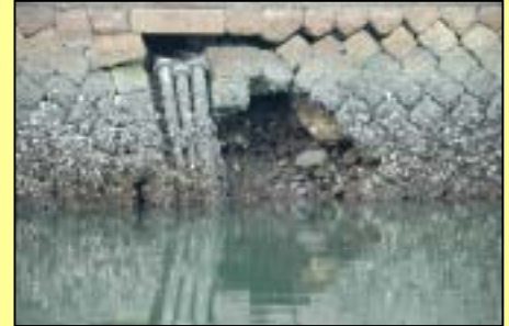
図 4.3 老朽化の状況
