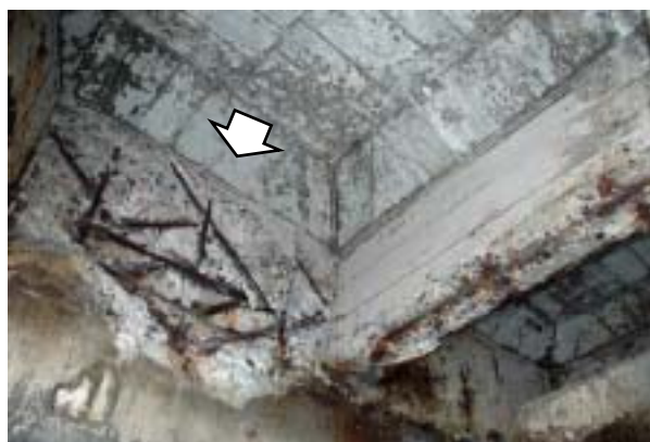
エプロン下部（コンクリートが剥離）
