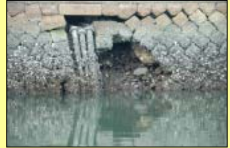
図 4.3 老朽化の状況
