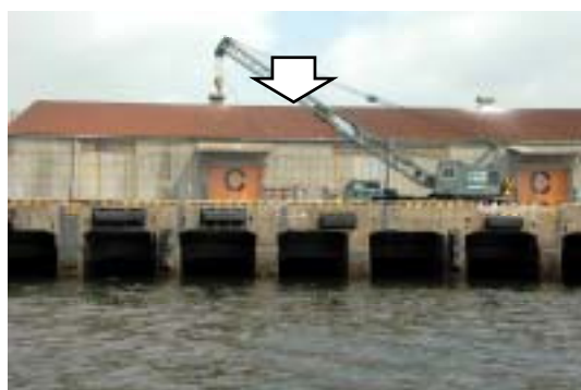
C 上屋（屋根の錆びによる痛みが著しい）
