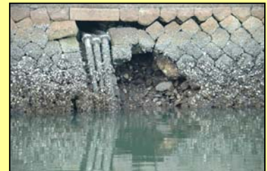
図 2.27 老朽化の状況
