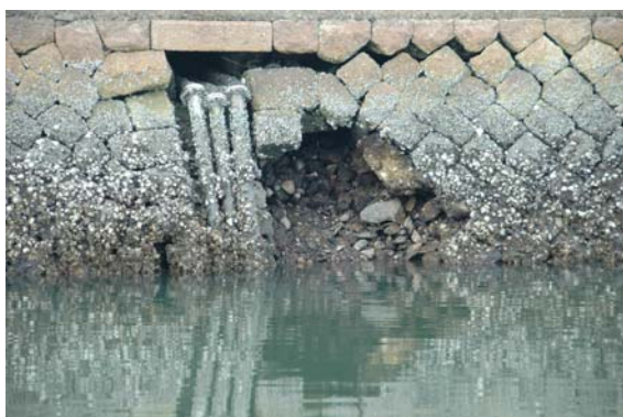
崩壊した石積構造の物揚場
