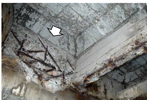
エプロン下部（コンクリートが剥離）
