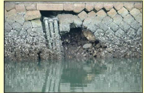
図 4.3 老朽化の状況
