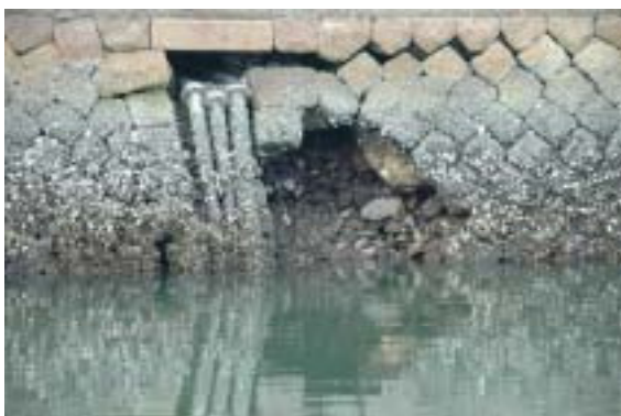
崩壊した石積構造の物揚場
