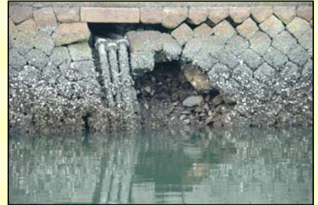
図 2.24 老朽化の状況
