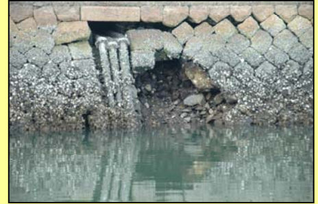
図 2.24 老朽化の状況
