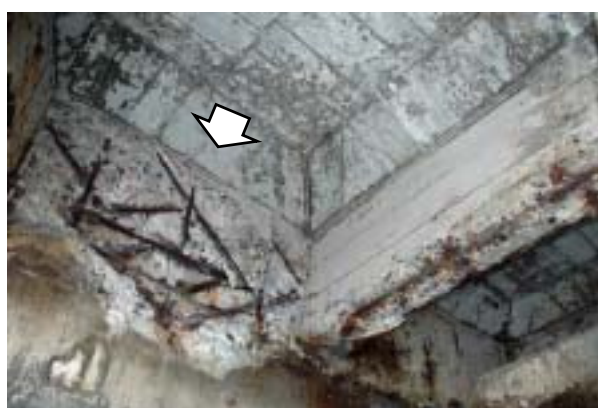
エプロン下部（コンクリートが剥離）
