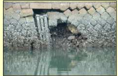
図 2.24 老朽化の状況
