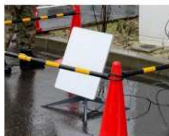
衛星インターネットサービスのアンテナ・機器の配備 (KDDI)
